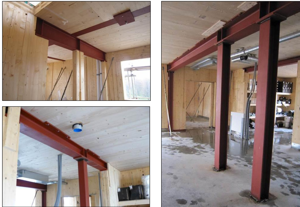
Figur 21. Brf. Strandsnäcken, Växjö: Stomkompletteringar i stål dimensionerade av CLT-leverantören Binderholz.
