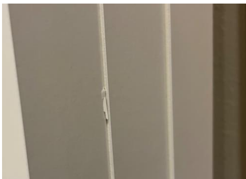
Figur 1. Exempel på skada mellan frontstycke och sidostycke på dörr. Foto: Fredrik Henriksson.
