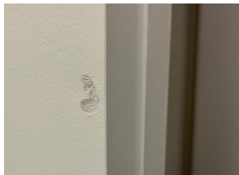
Figur 2. Exempel på skada i dörrskinn. Foto: Fredrik Henriksson.
